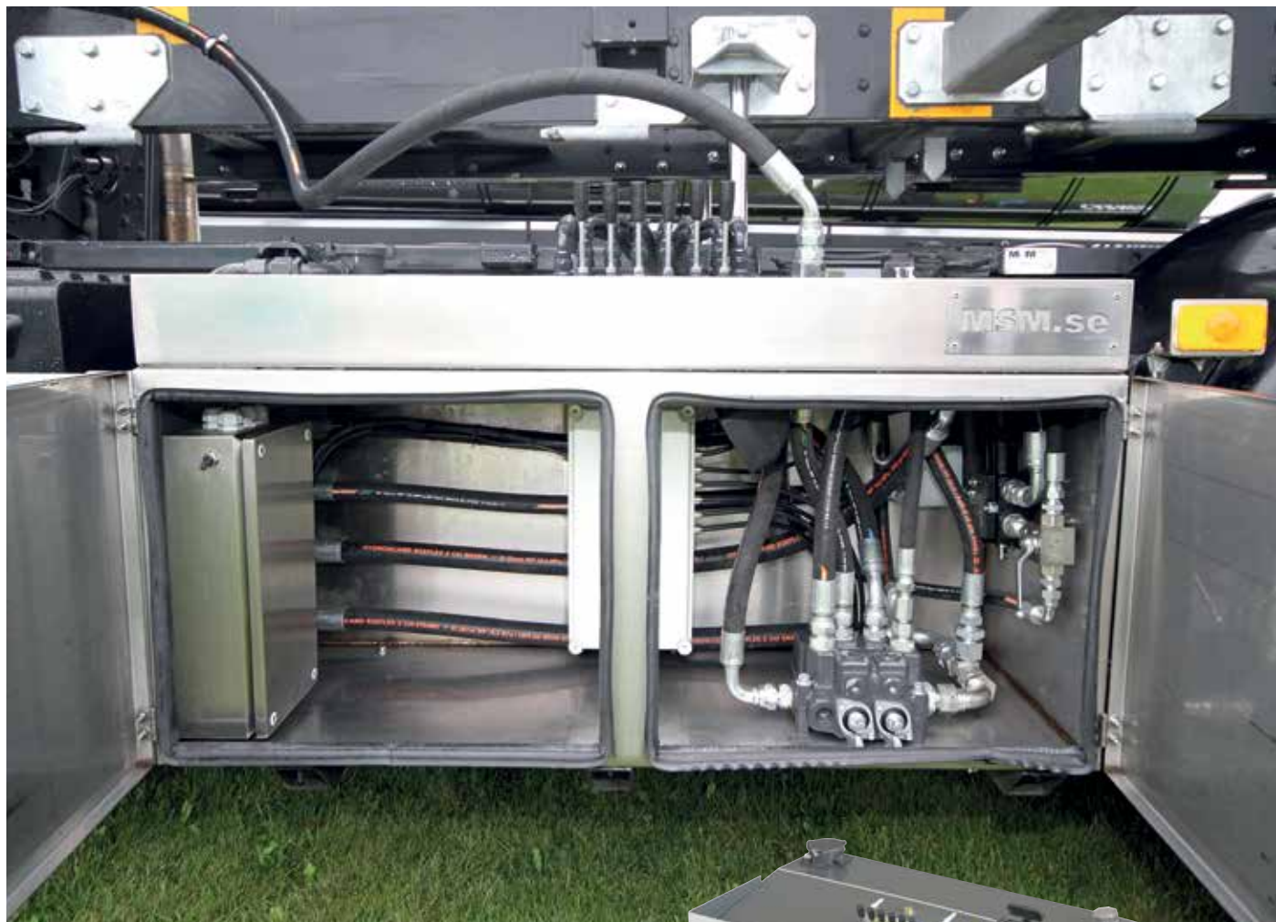
El, luft och hydraulik integrerat i det servicevänliga skåpet.
